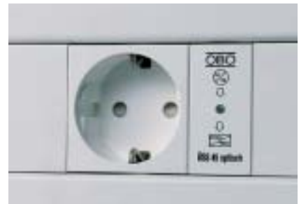
Schuko-Steckdose und Überspannungsschutz-Modul
