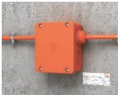
Montierter Kabelabzweigkasten für den Funktionserhalt
